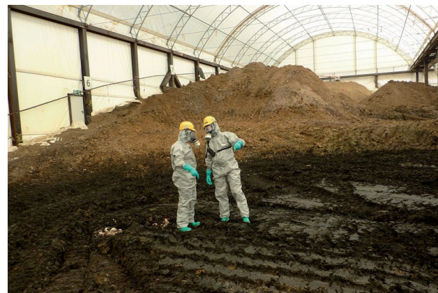
Bodenwäsche bei KIBAG RE, Schweiz
